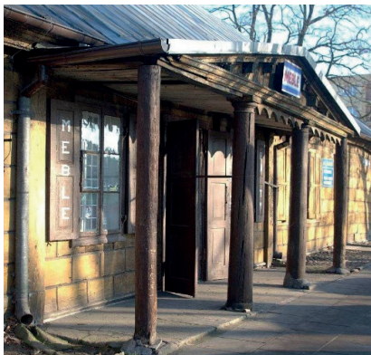
Ryc. 2. Portyk kolumnowy (ganek) przed renowacją 2003r. Kutno
